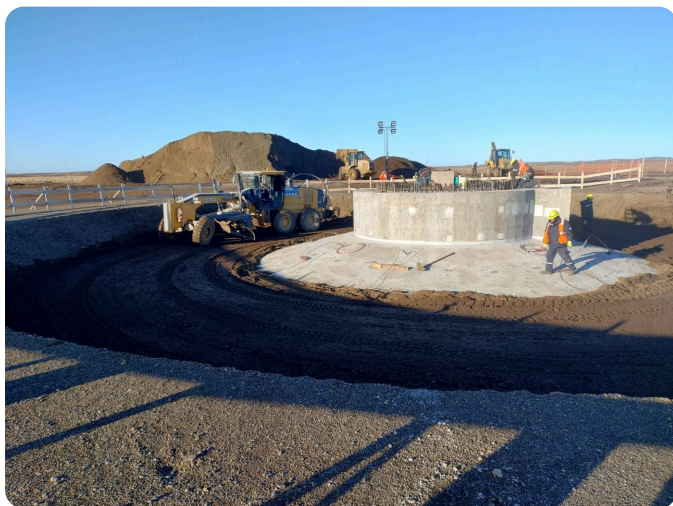
PLATAFORMA DE AEROGENERADOR
